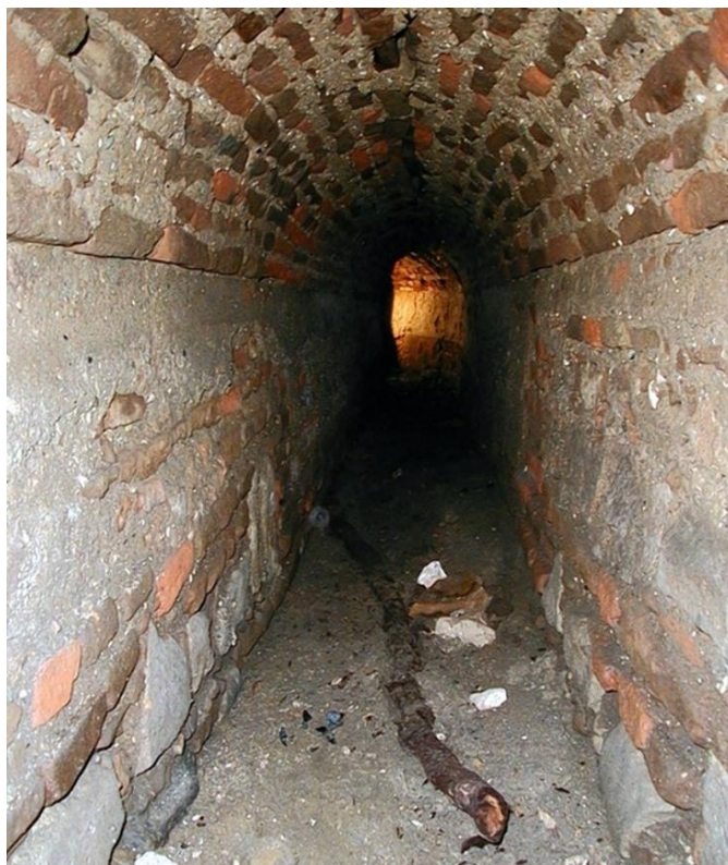
Figura 25: Galeria de águas pluviais no estado em que se encontrava. Fonte: Albuquerque e Lucena, 2001.
